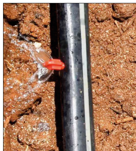
► Micro-jet irrigation system
